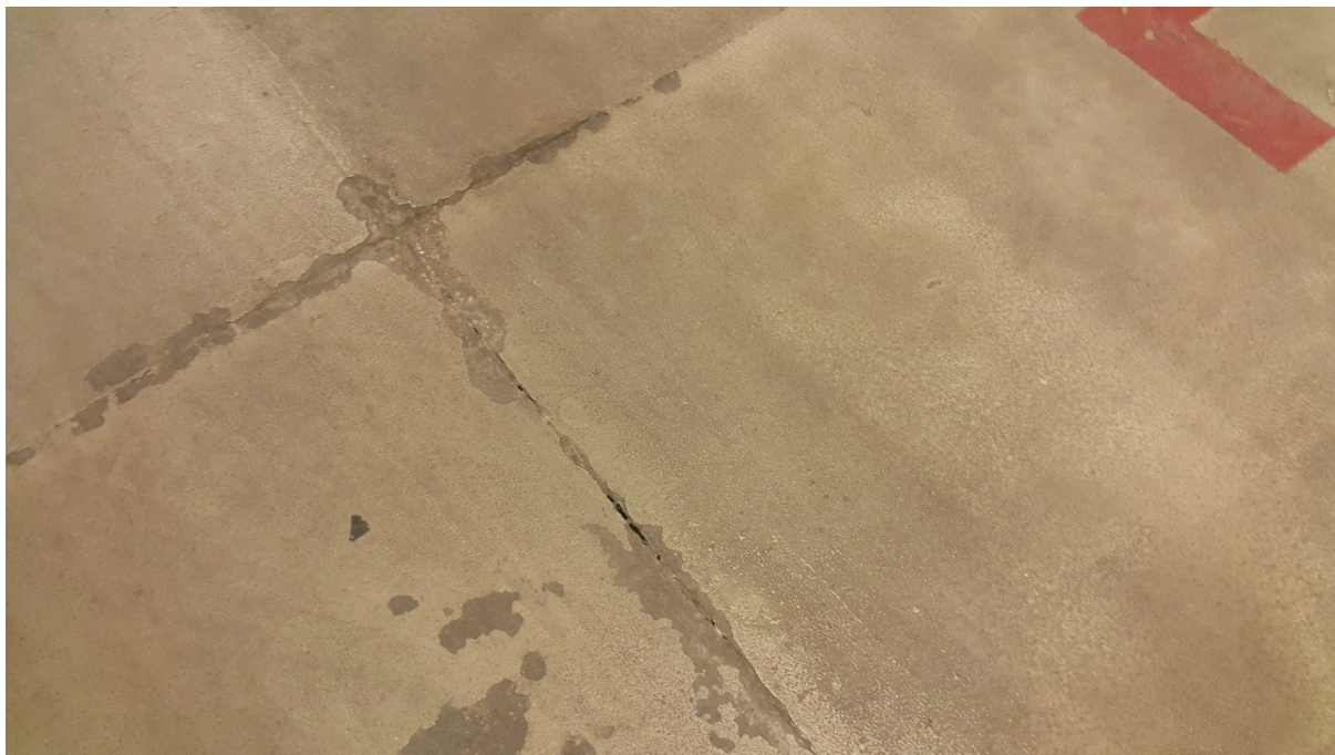
Fotografia nr 11 – Miejscowe uszkodzenia przy dylatacjach płyty betonowej parkingu.
