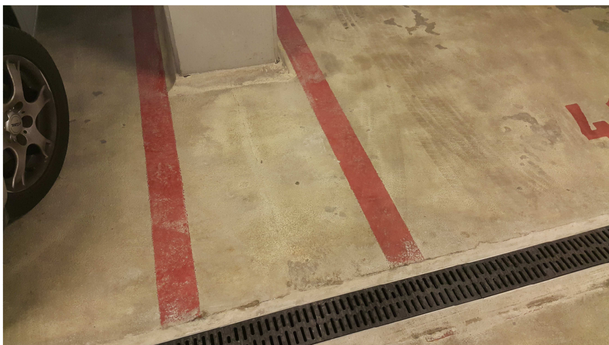
Fotografia nr 10 – Połączenie (wyoblenie, faseta) między posadzką a ścianami, uzupełnienie posadzki po wymianie koryt odwadniających
