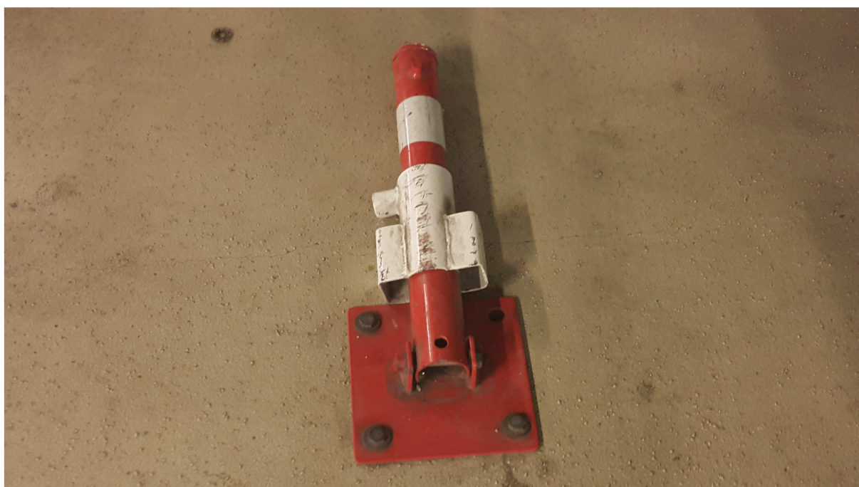
Fotografia nr 6 – Przykładowy słupek parkingowy składany do wymiany (łącznie 2 szt)
