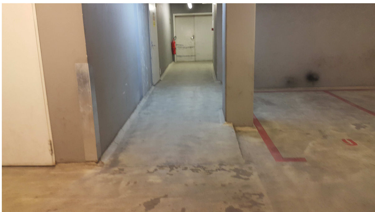
Fotografia nr 12 – Rampa łącząca garaż z korytarzem technicznym
